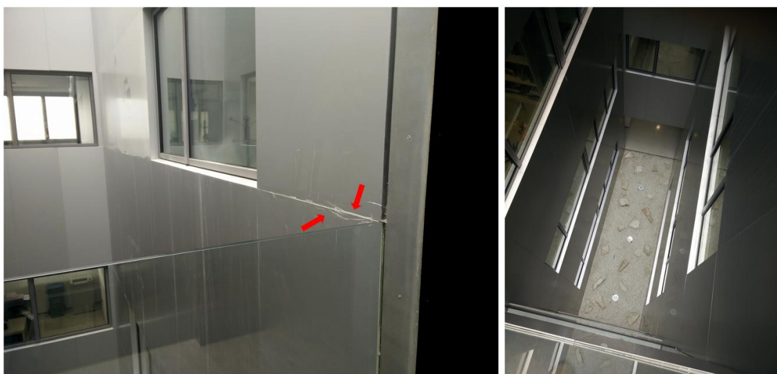
Figura 2. Paneles de la fachada que se desprenden (Izda). Las flechas señalan la unión de dos paneles que se han asegurado con cinta adhesiva. En la figura derecha aparece el suelo de la terraza afectada (planta 7ª). La altura a la que se encuentran los paneles y su fino grosor hace que estos representen un grave peligro si se desprenden, ya que actuarían a modo de cuchillas.
